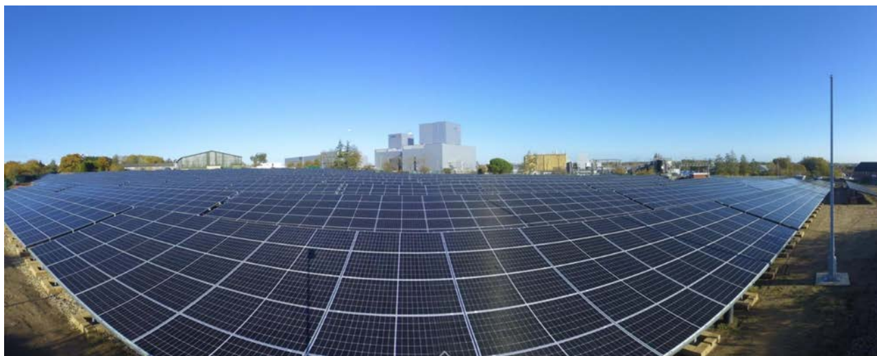
Centrale solaire du site de Haverhill, opérationnelle en 2023
